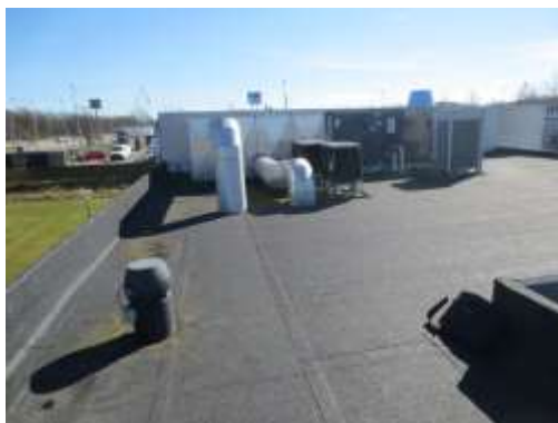
Ventilationsanlæg placeret på tag
