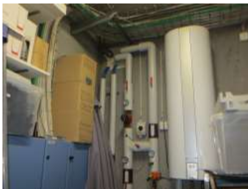
Vand og varme installationer
