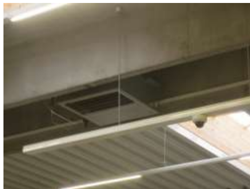
kalorifere placeret under loft i lager
